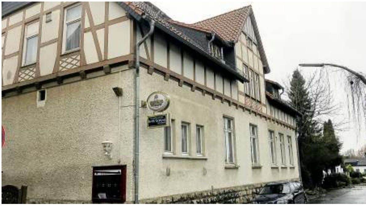
Die Alte Schule in Melverode ist seit 2016 geschlossen. Sanierungsmaßnahmen sind notwendig.
